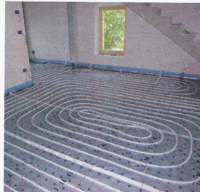
Sistema di riscaldamento radiante a pavimento.
